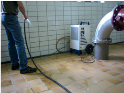
Abb. 12 Strahlwassereinwirkung auf Anschlussleitung und Betriebsmittel
